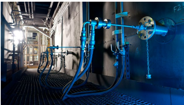
Przykładowa realizacja Technologii SNCR EESA – Instalacja do ograniczania emisji tlenków azotu (NO x ) zabudowana na kotle w Elektrowni Rybnik – Zespół lanc wtryskowych
