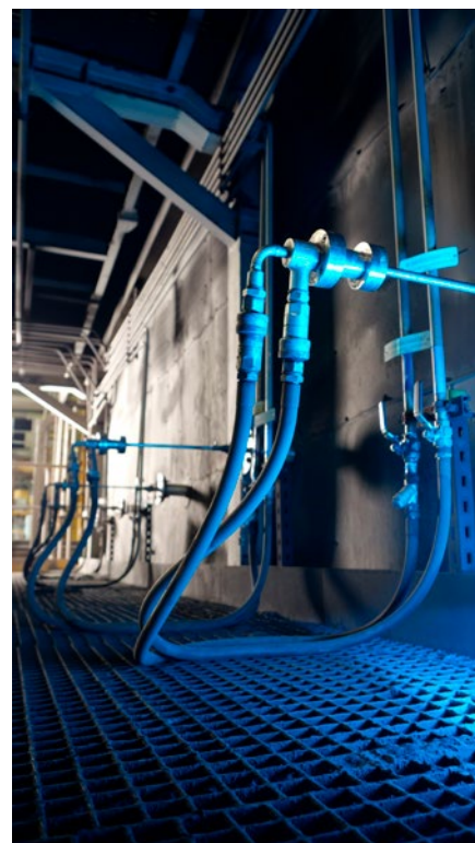
Przykładowa realizacja Technologii SNCR EESA – Instalacja do ograniczania emisji tlenków azotu (NOx) zabudowana na kotle w Elektrowni Rybnik – Lanca wtryskowa
